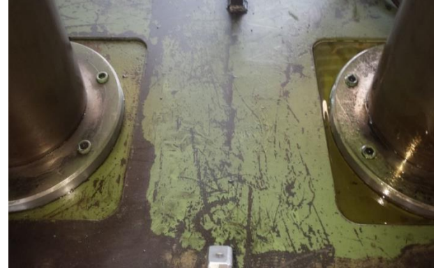
Figura 5 Fuga de aceite de una prensa hidráulica Fuente: Acervo personal
